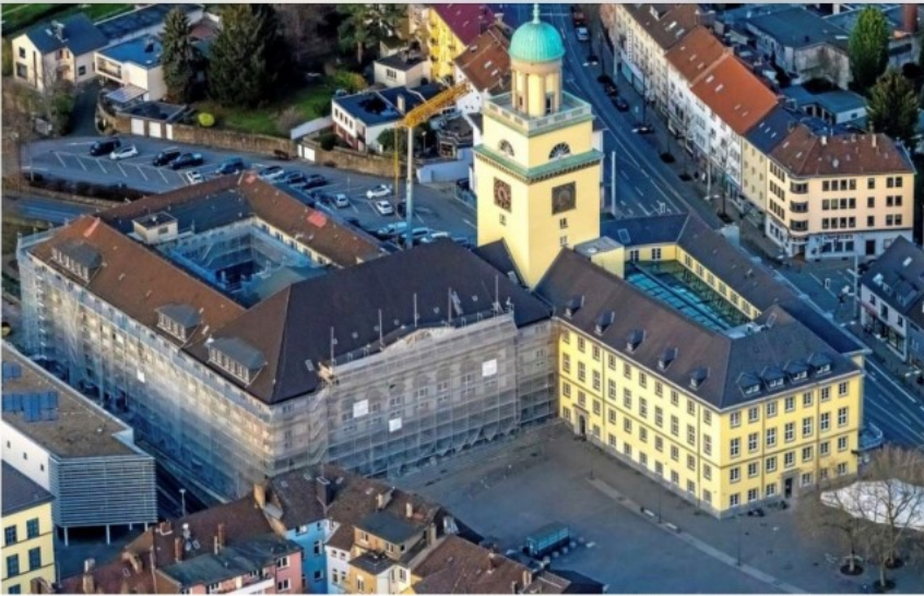
Im eingerüsteten Nordflügel des Rathauses sind marode Zwischendecken gefunden worden. Die Sanierung soll bis Herbst 2023 dauern.
